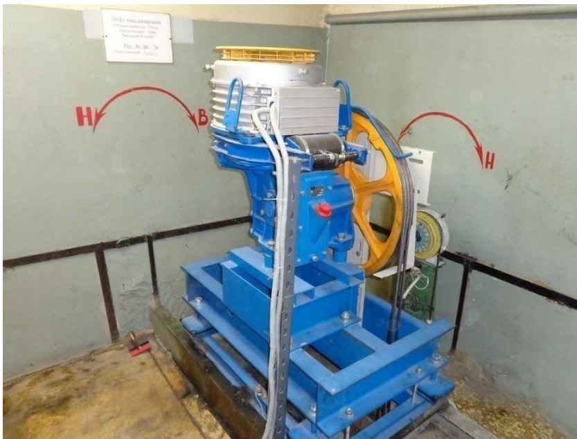
Рис. 2. Двигатель в машинном отделении лифта в одном из высотных зданий г. Владикавказ
